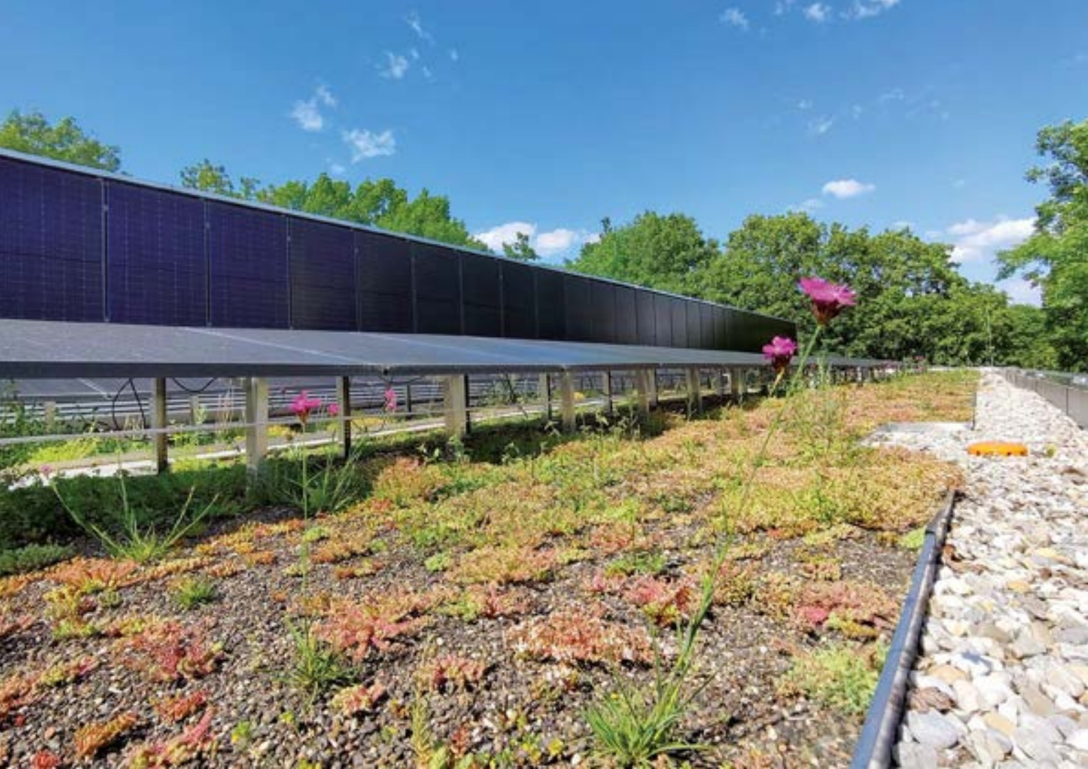
Solaranlage auf dem Dach des Hauses der Architektur
