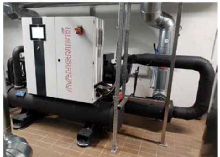
Abb. 4 Hochtemperaturwärmepumpe der Firma Ochsner
